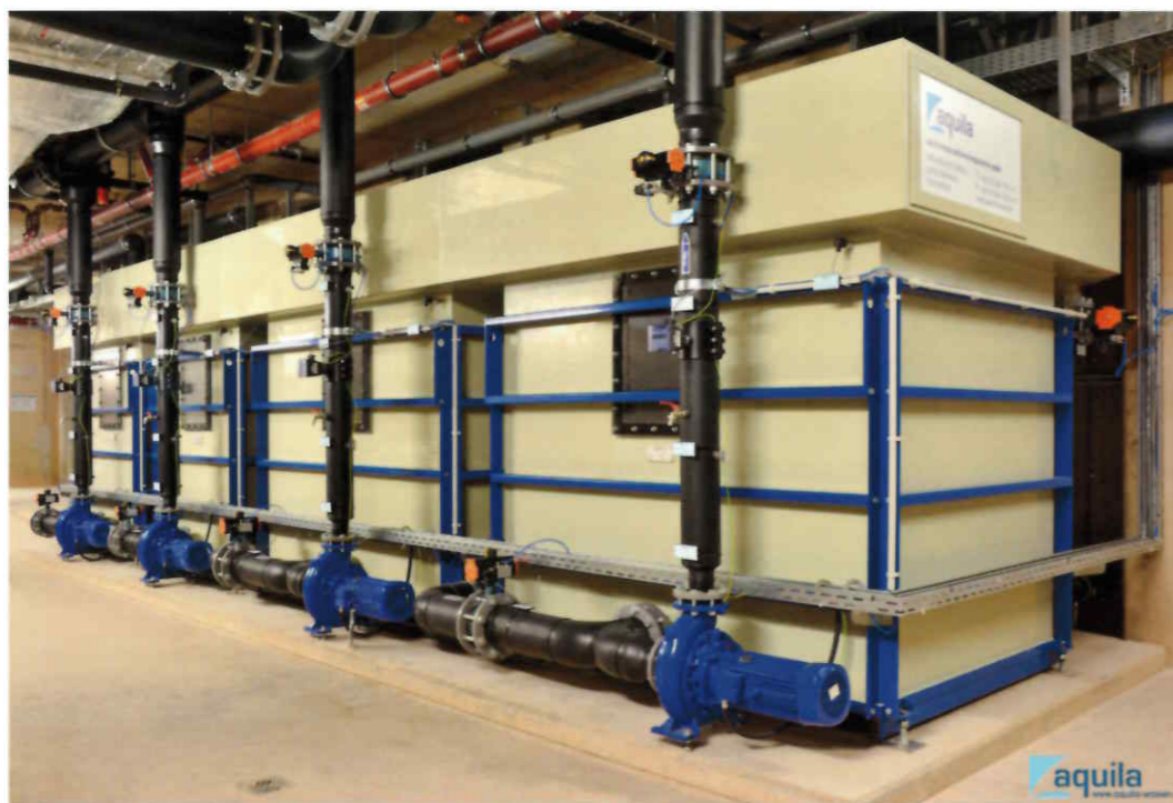
Ein fertiger Technikeller der aquila wasseraufbereitungstechnik GmbH.
